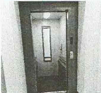
【エレベーター】 1階⇄2階の移動が しやすくなりました。
