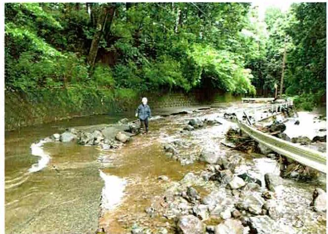
谷津川沿いの崩壊した市道2154号線
