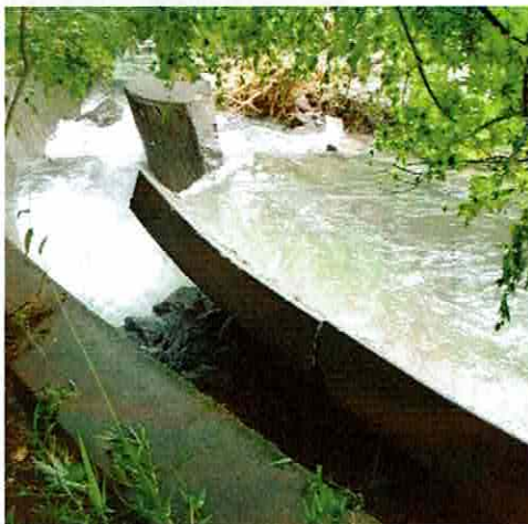
7班脇の谷津川で破損した護岸
