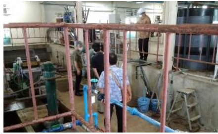
生活雑排水が流れ込む 流入ポンプ槽
