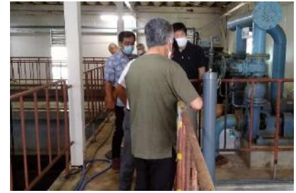
最終の消毒槽から 谷津川へ放流
