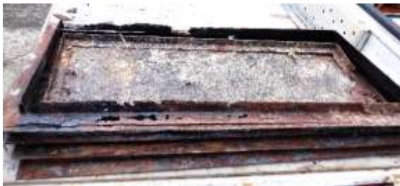
錆、劣化がひどいチェッカープレート裏側
