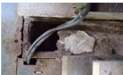
ステップ足元にある腐食による穴
