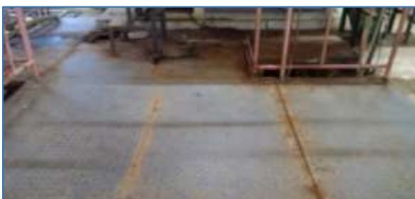
腐食による穴、錆のあるチェッカープレート
