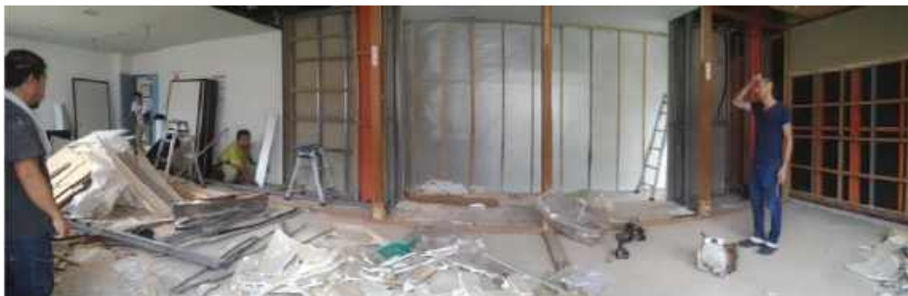
【和室の壁と床・押入れが撤去…外壁との壁に断熱材が入っていない!?!】
